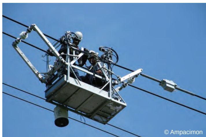
Capteur ADR-Sense, ELIA Doel (installation)
